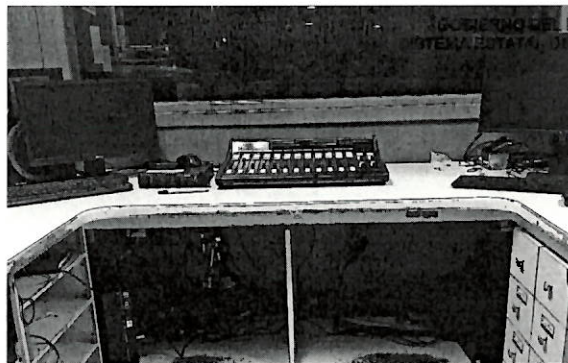
Consola nueva en operación
