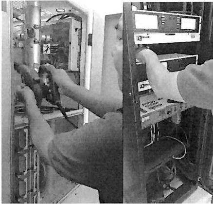
Aspiración del equipo transmisor, monitor de modulación, monitor de estereofonía y enlace estudio-planta
