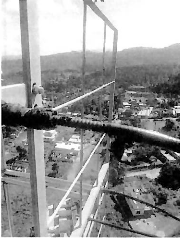
Precia revisión se detectó daño en línea de 1/2 y conector afectando a la transmisión, se desatornillo y se baja elemento
