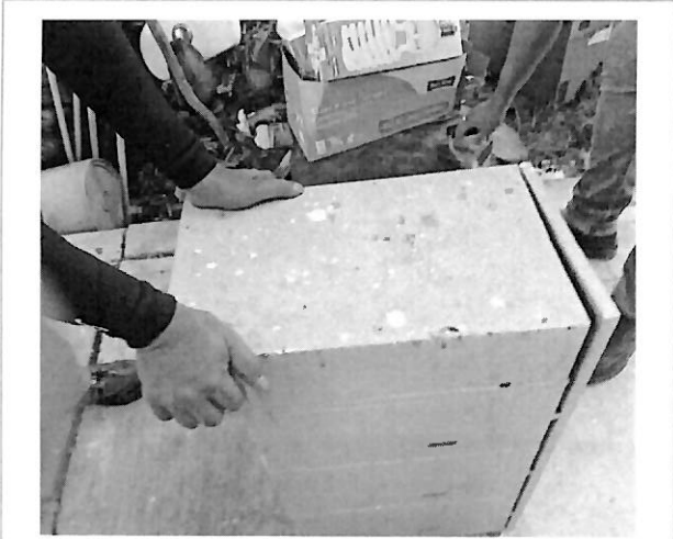
Preparación de regulador trifásico reparado para protección en cabinas de transmisión y producción.
