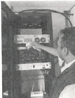
Limpieza de transmisor
