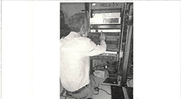
Limpieza y status del software de la electrónica de la microonda
