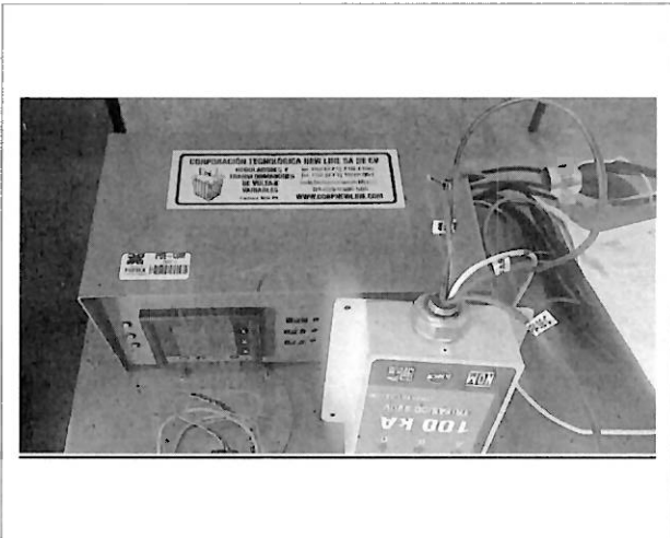
Limpeza de regulador de voltaje, y revisión de las lecturas de salida de voltaje, y revisión del estado del supresor de picos
