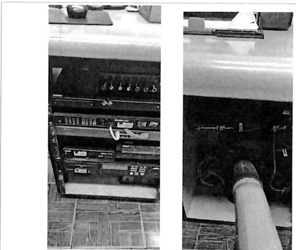
Limpieza del blade de consola y equipo de transmisión; limpieza de switch y rack de equipos
