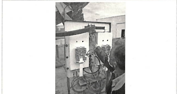
Limpeza de amplificadores del telepuerto.
