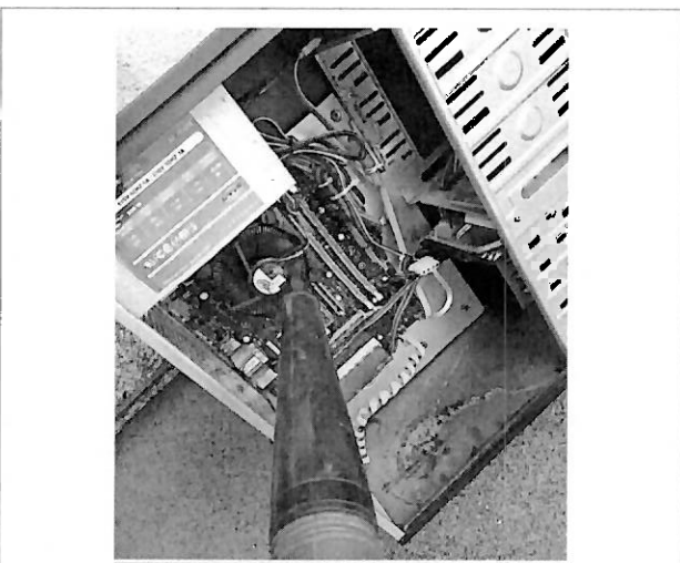
Limpeza de CPUS de las cabinas de transmisión, producción y del área de noticias
