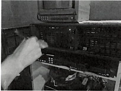
Limpeza a la electrónica del sistema de almacenamiento.
