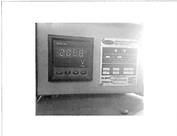
Regulador de voltaje que suministra energía al transmisor, equipos de transmisión, equipo de cámaras, se muestra bajo voltaje entre fases
