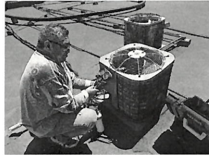
Medición de gas
