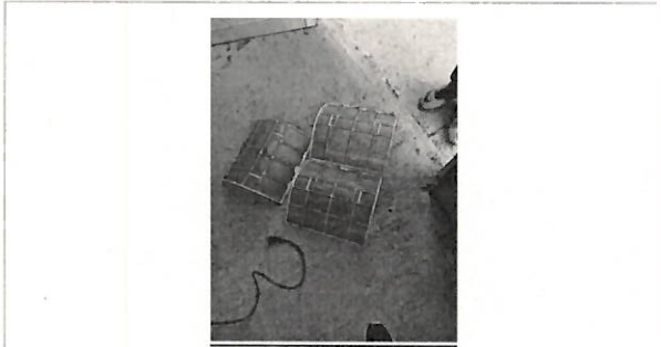
Cambio de filtros retenedores de polvo
