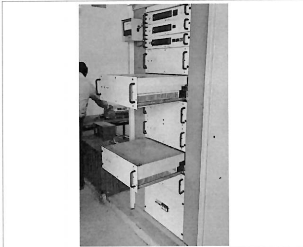
Se retiran los dos módulos amplificadores del Transmisor de Radio de FM que contienen los ventiladores dañados
