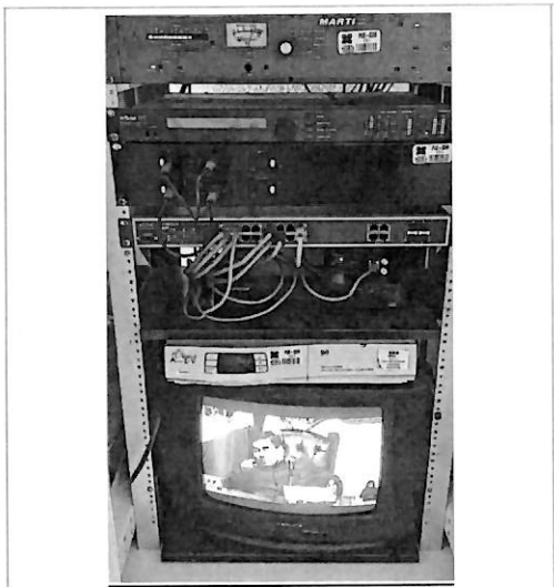
Se instala receptor y se configura, se revisan niveles de calidad y señal siendo estos óptimos.
