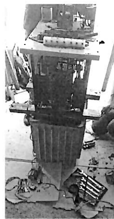
Se cambiaron 3 cepillos con dos carbones c/u 1 motor reductor 2 switches limitadores y 1 tarjeta electrónica de control.
