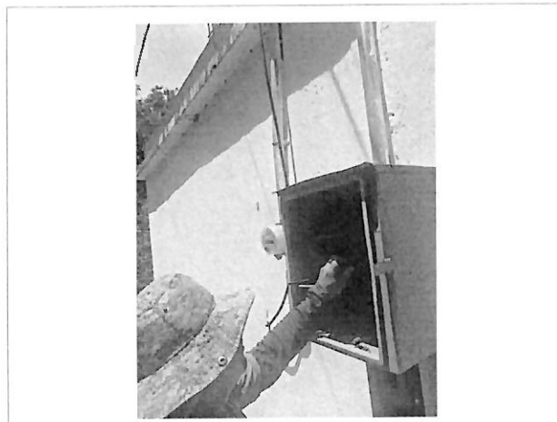
Retiro de equipamiento que en administraciones anteriores se instaló, pero que la CFE no tuvo disponibilidad del servicio.
