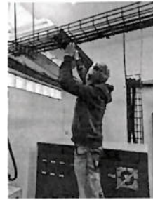
Se realizó mantenimiento preventivo a equipos periféricos del transmisor ( Guías de Onda )
