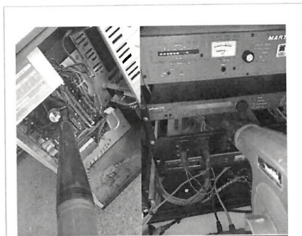
Se limpiaron los cpu's y los equipos en el rack de transmisión en estudios.
