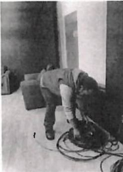
Orden de cableado
