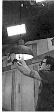
Cambio de bombilla de la luminaria tipo "Cazuela"
