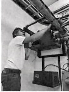
Se efectuó mantenimiento preventivo a equipos periféricos del transmisor ( Control de Temperatura )
