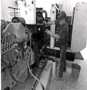
Se le proporciono limpieza superficial al generador de energía
