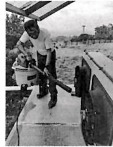
Se hizo mantenimiento preventivo a equipos periféricos del transmisor ( Extractores de Aire )
