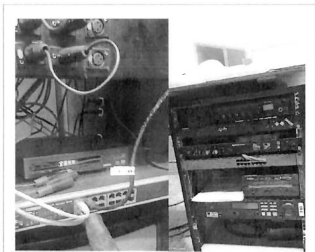
Limpeza del rack de los equipos de transmisión, y del rack de los equipos de audio en la cabina de transmisión.
