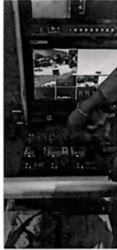
Remoción de polvo a los controles de video de cámaras
