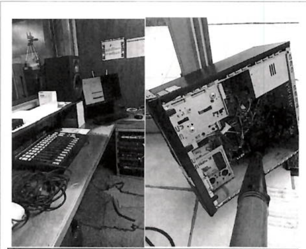
Limpeza de consola revisión de cableado de micrófonos, y limpieza de CPUs
